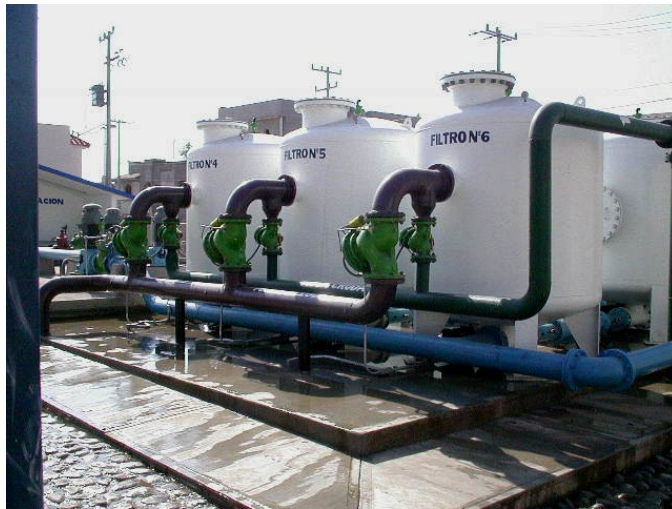
Figura 4. Filtros de la planta “Campaña II”
